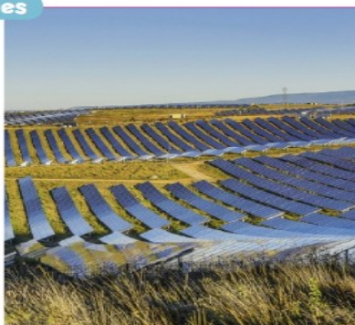
1 Une centrale solaire produit de l'énergie électrique.
